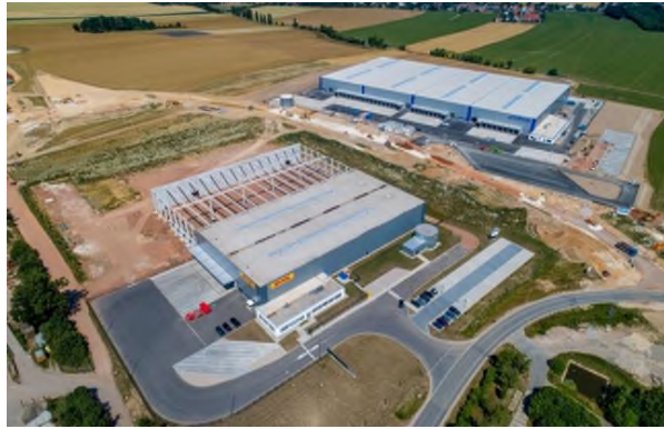
Die neue Staatsstraße 288 wird zwischen den beiden Industriehallen durch das Gewerbegebiet verlaufen. Foto: Metawerk
